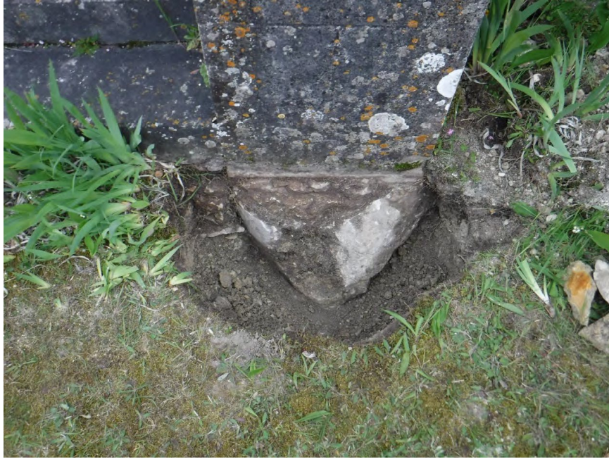
Photo 3 : Sondage réalisé auprès du contrefort gauche ; la partie supérieure présente une dégradation mécanique. Zoom sur la structure apparente de la trame. Pierre taillée assise sur du mortier de chaux et de sable à la surface de trame parée avec le même mortier. Parement de la fondation sur la base de celui relevé dans le sondage auprès du contrefort gauche. Photo Marcin Ciba, mai 2019
