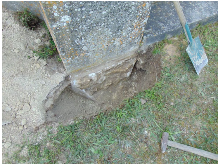
Photo 2 : Sonde auprès du contrefort gauche ; la partie supérieure présente une dégradation mécanique. Photo Marcin Ciba, mai 2019
