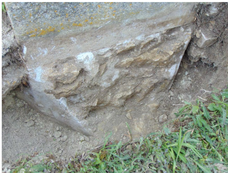
Photo 2 : Sondage réalisé auprès du contrefort gauche ; la partie supérieure présente une dégradation mécanique. Zoom sur la structure apparente de la trame. Pierre taillée assise sur du mortier de chaux et de sable à la surface de trame parée avec le même mortier. Photo Marcin Ciba, mai 2019
