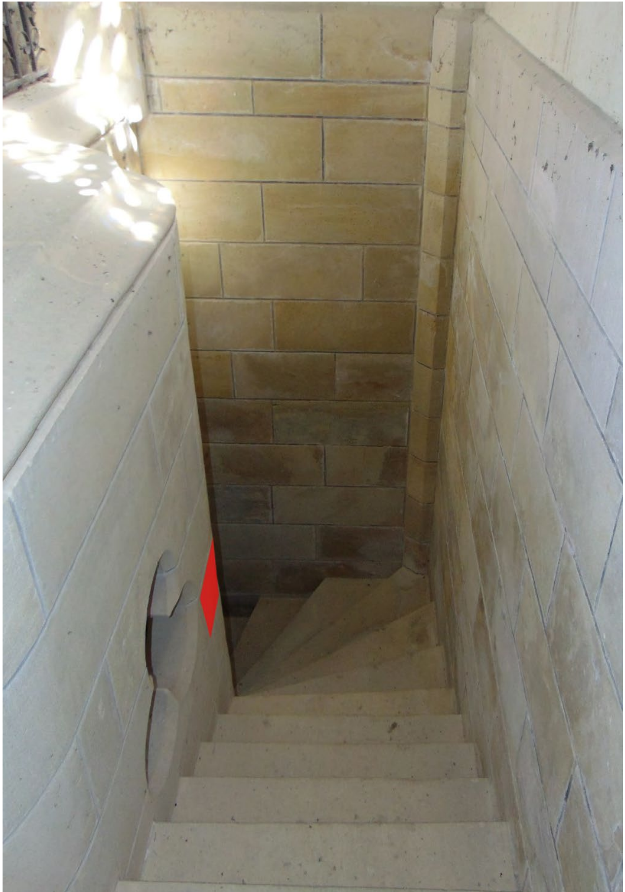
Photo 1. La cage d'escalier gauche (en se plaçant face à l'autel). La pierre étudiée est visualisée en rouge. Des décolorations apparaissent sur les murs, dues aux divers degrés d'humidité.
